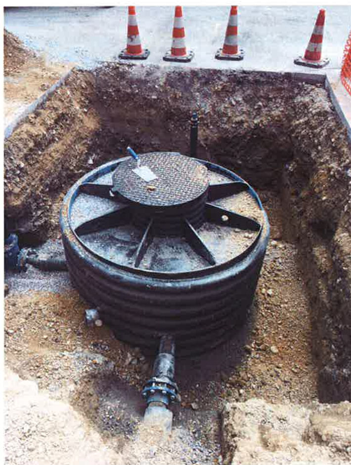
Merilni vodovodni jašek Selo
